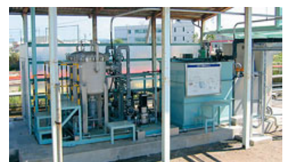
米子施設区では、西鳥取車両支部の排水処理装置の老朽取り替えにおいて、環境に配慮した検討を行い、エネルギー消費量が少ない電解処理方式を採用しました。
